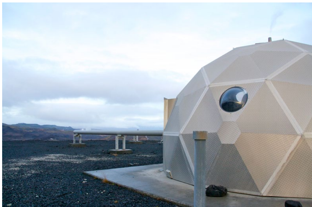
Island har lenge vært kjent for geotermiske kilder. Her vises deler av kraftanlegget på Hellisheidarvirkjun sørøst for Reykjavik (Foto: Per Anda).
