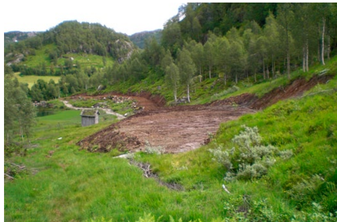
Ulovlig veg bygd inn til Kilen i Hamrabø.
